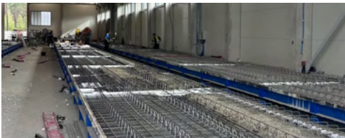
The tables are equipped with suitable side formworks necessary for molding filigree-type ceilings. Stoły posiadają odpowiednie szalunki boczne niezbędne do formowania stropów typu filigran.
